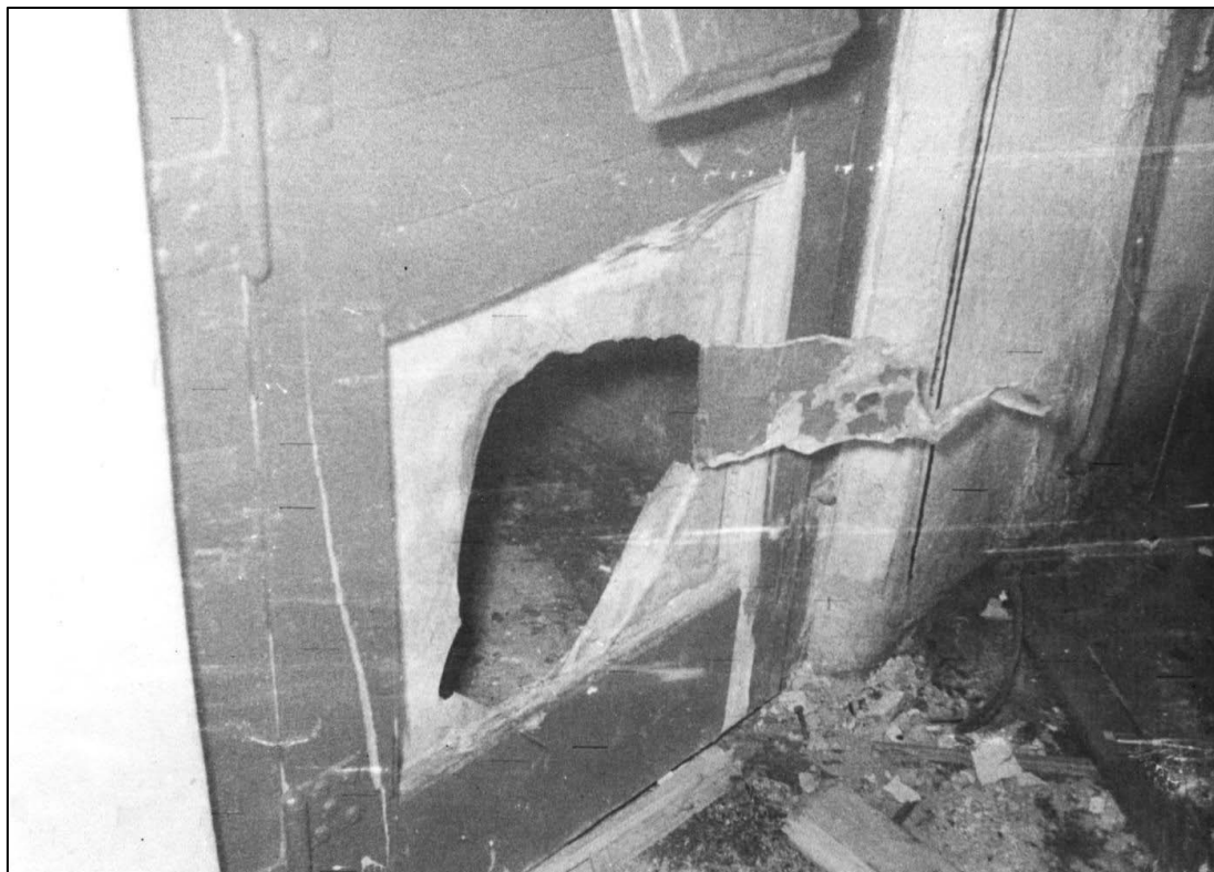
Zdemolované dveře u cely samovazby v suterénu (foto: SOKA Liberec)
